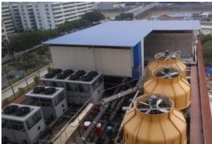
示范系统全景
